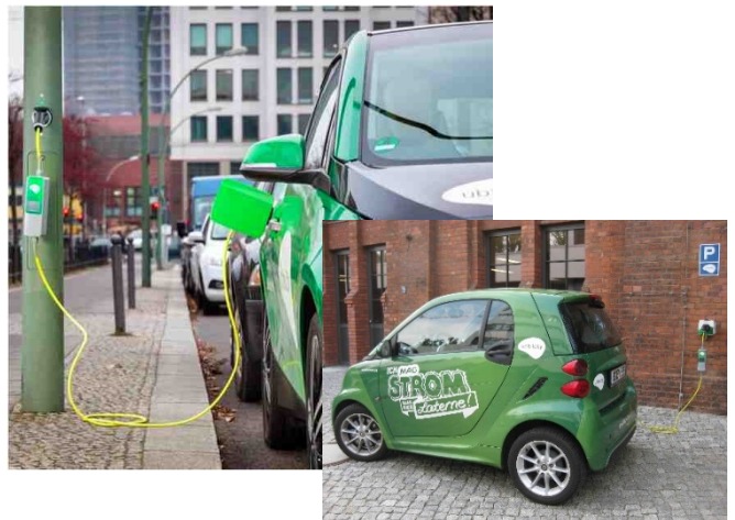
街灯充電スポット（左）と壁面充電スポット（右）
