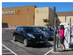
▲スーパー「Walmart」に設置された急速充電器
