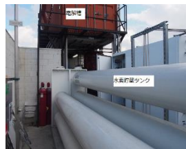
▲水素貯蔵タンクは地上にむき出し。ガス漏れ検知器を設置しているのみ
